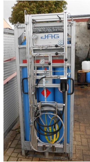
Abbildung 7: Überströmpanel am Flaschenbündel aufgebaut
