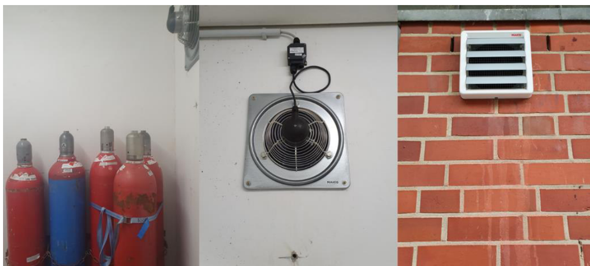
Abbildung 2: Gasflaschenlager für die Lagerung des Wasserstoffs für Versuchszwecke (links) sowie bauliche Integration eines EX-geschützten Lüfters (mittig und rechts) zur Erzeugung eines technischen Luftwechsels.
