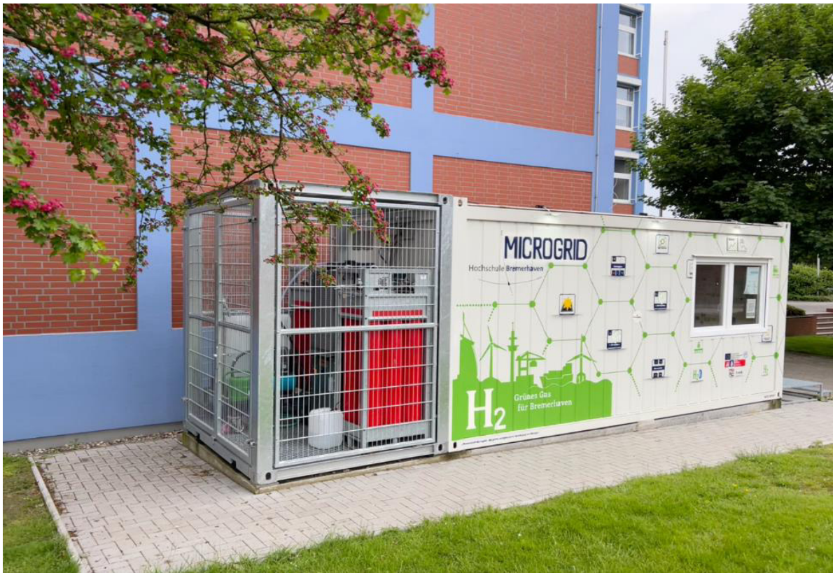
Abbildung 1: Microgrid-Container der Hochschule Bremerhaven mit Wasserstoffspeicher im Gitterkäfig [Bildquelle: David Stephan]
